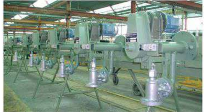
Reparto soffiatori a lancia rotativa Rotary lance soot blower bay
