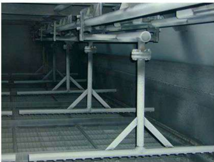
Dettaglio lance a rastrello interno impianto catalitico DeNox - SCR Rake lance detail inside a SCR DeNox plant
